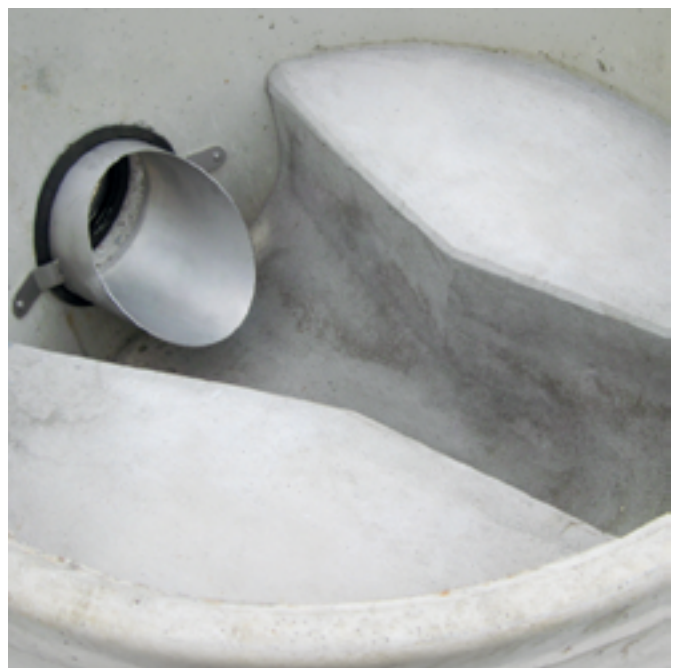
Ablaufrohr im Probennahmeschacht
