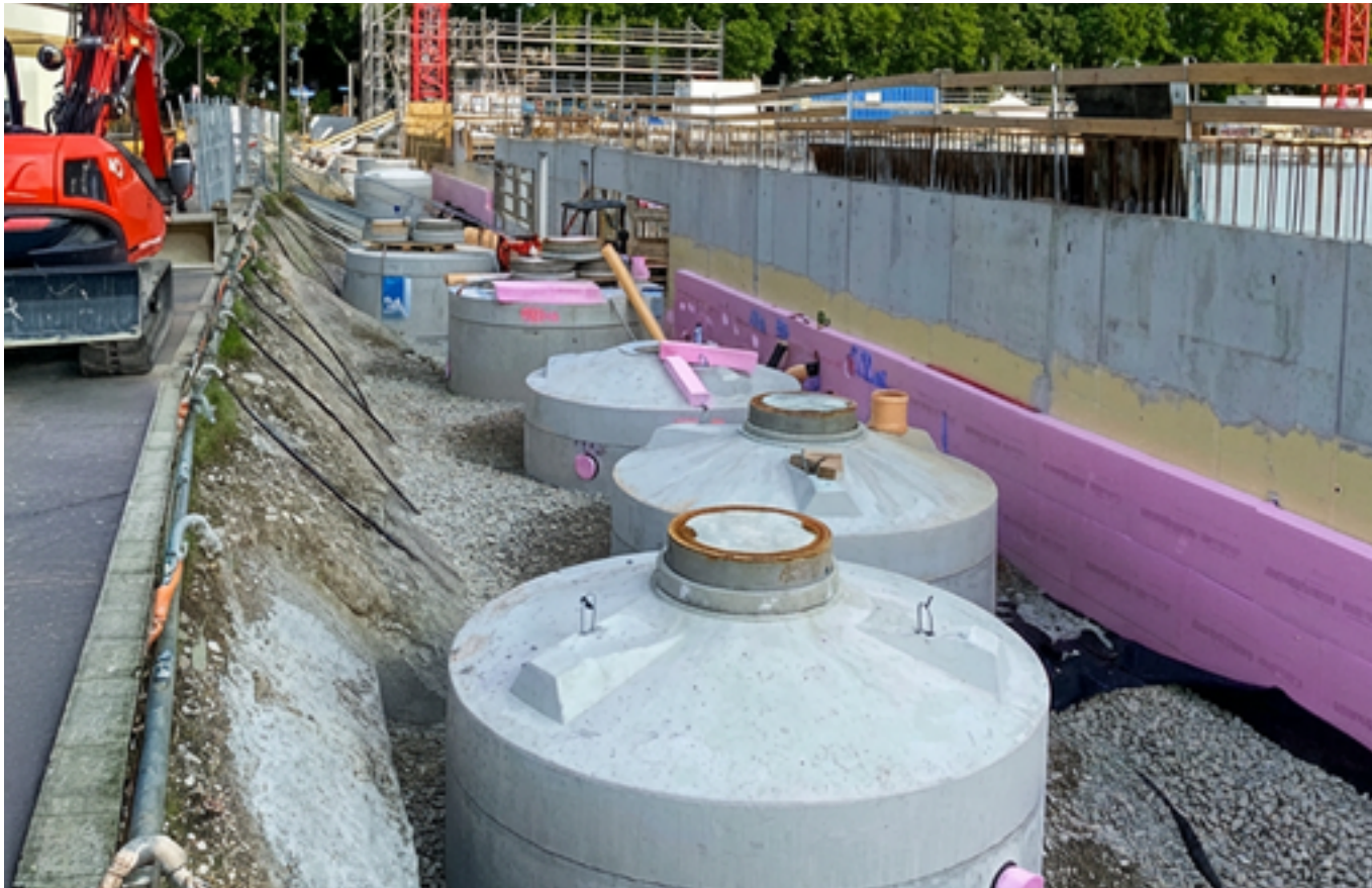
Zisternen für Regenwassernutzung: Die Auslegung der Schachtanlage folgt der Nutzenanforderung der Behälter aus Einbausituation und Verkehr.
