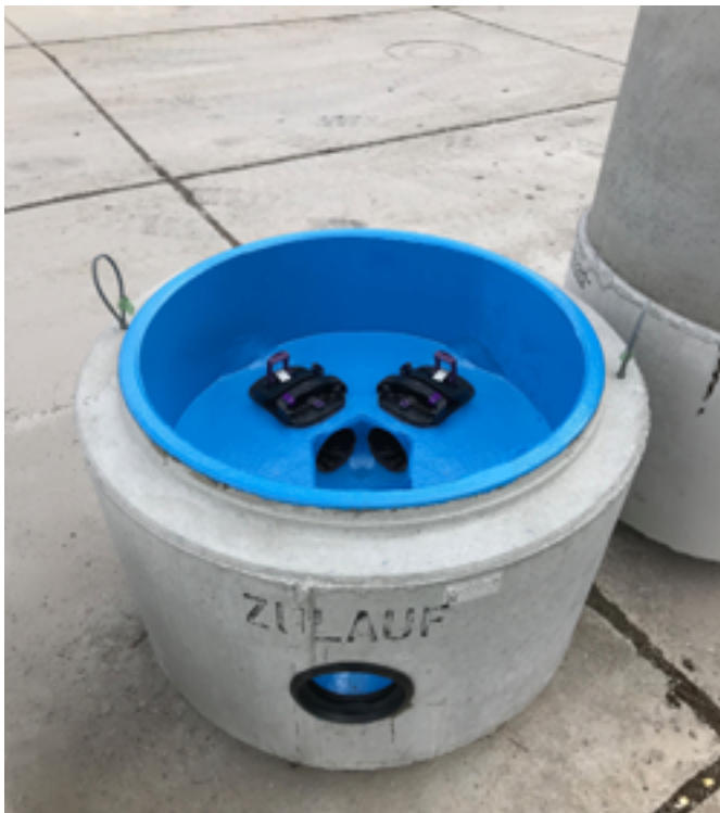
Umschaltenschacht zur Steuerung verschiedener Abwasserströme
