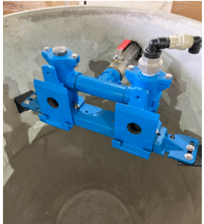
Einbaukomponenten im Pumpenschacht
