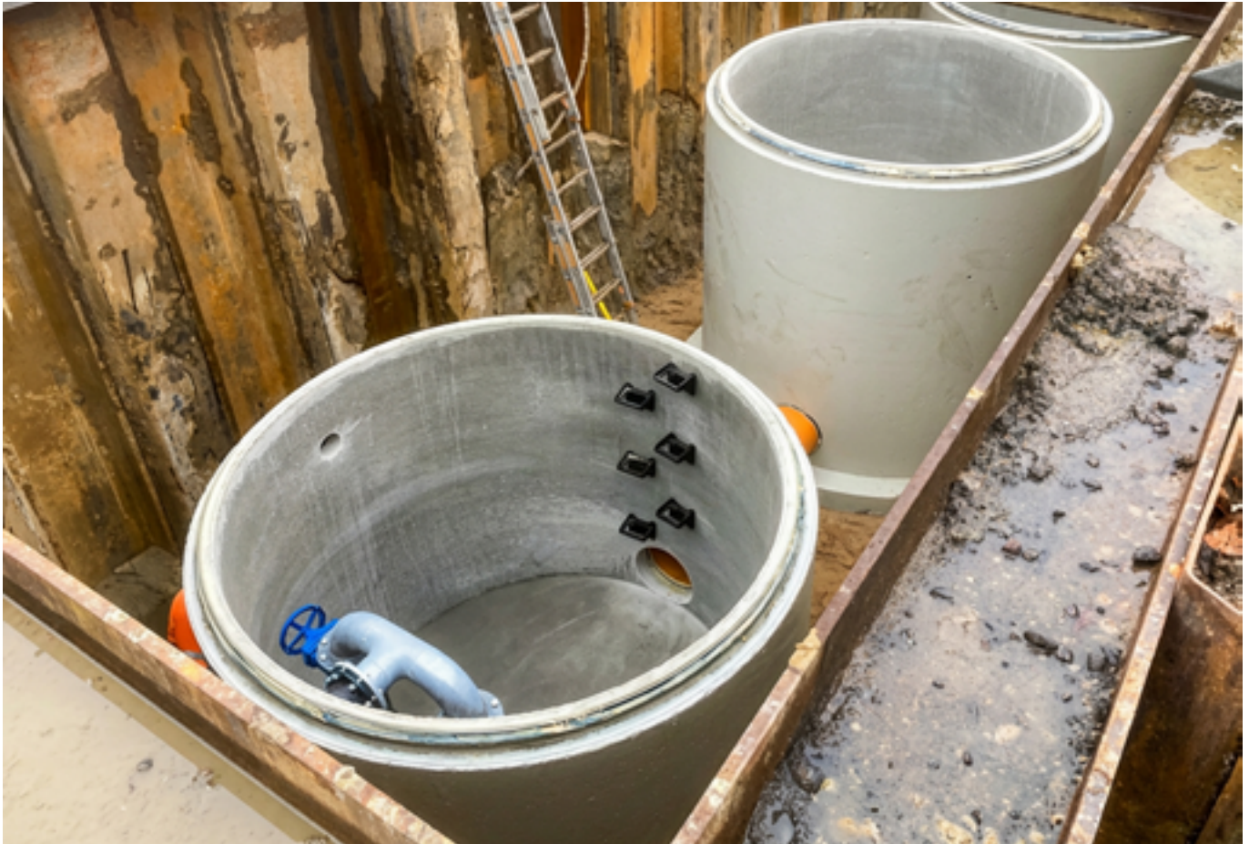
Regenwasser-Rückhaltung mit Doppelpumpstation
