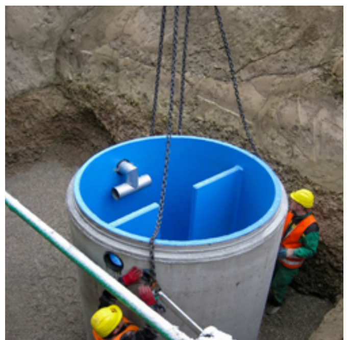
Funktionsbecken des Brauchwasser-Recyclings
