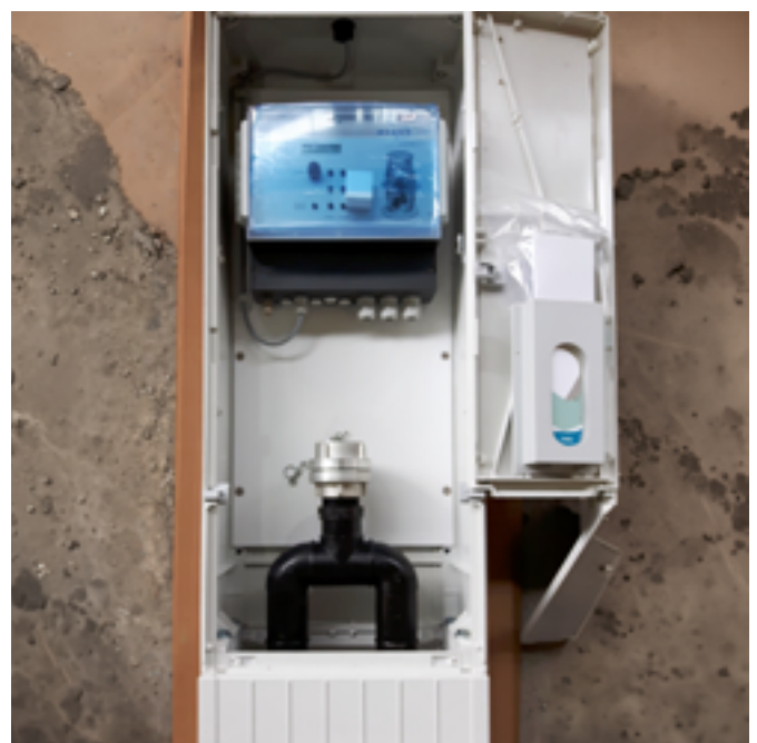
Freiluftschrank mit Steuerung (oben) und Rückstauschleife (unten)
