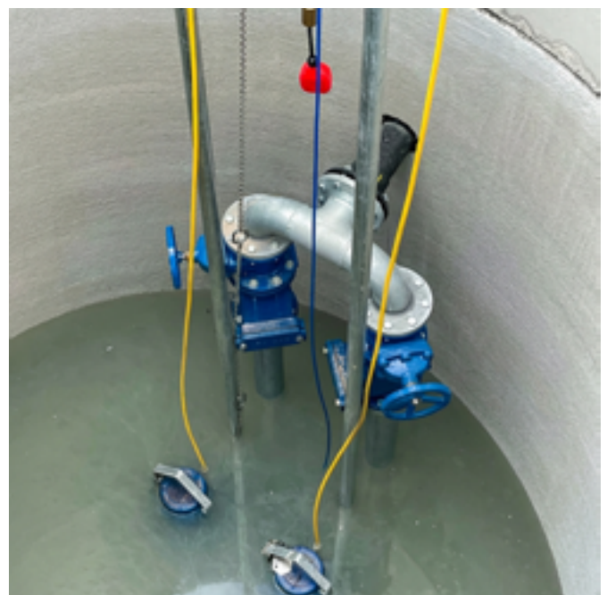
Pumpstation zur Regenwasserförderung
