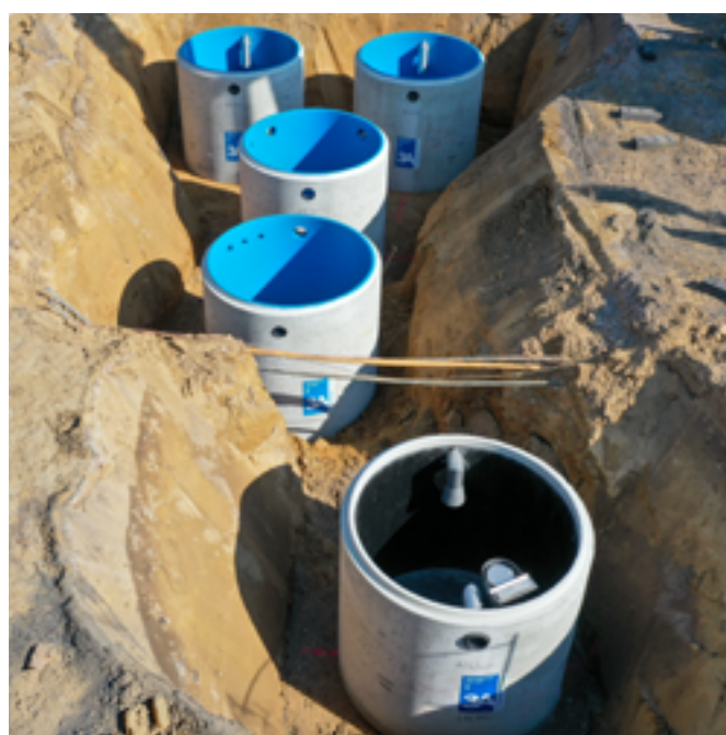
Beckentechnik für Wasserrecycling
