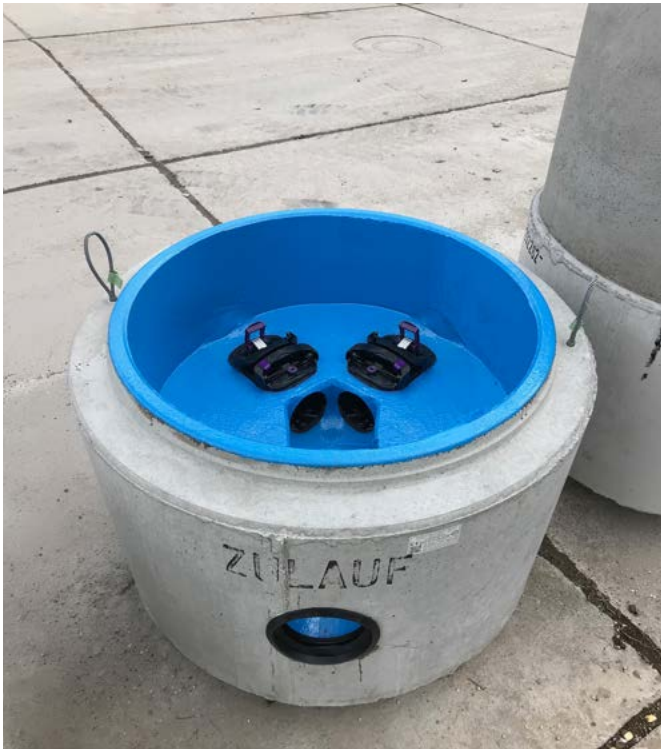
Umschalterschacht zur Steuerung verschiedener Abwasserströme
