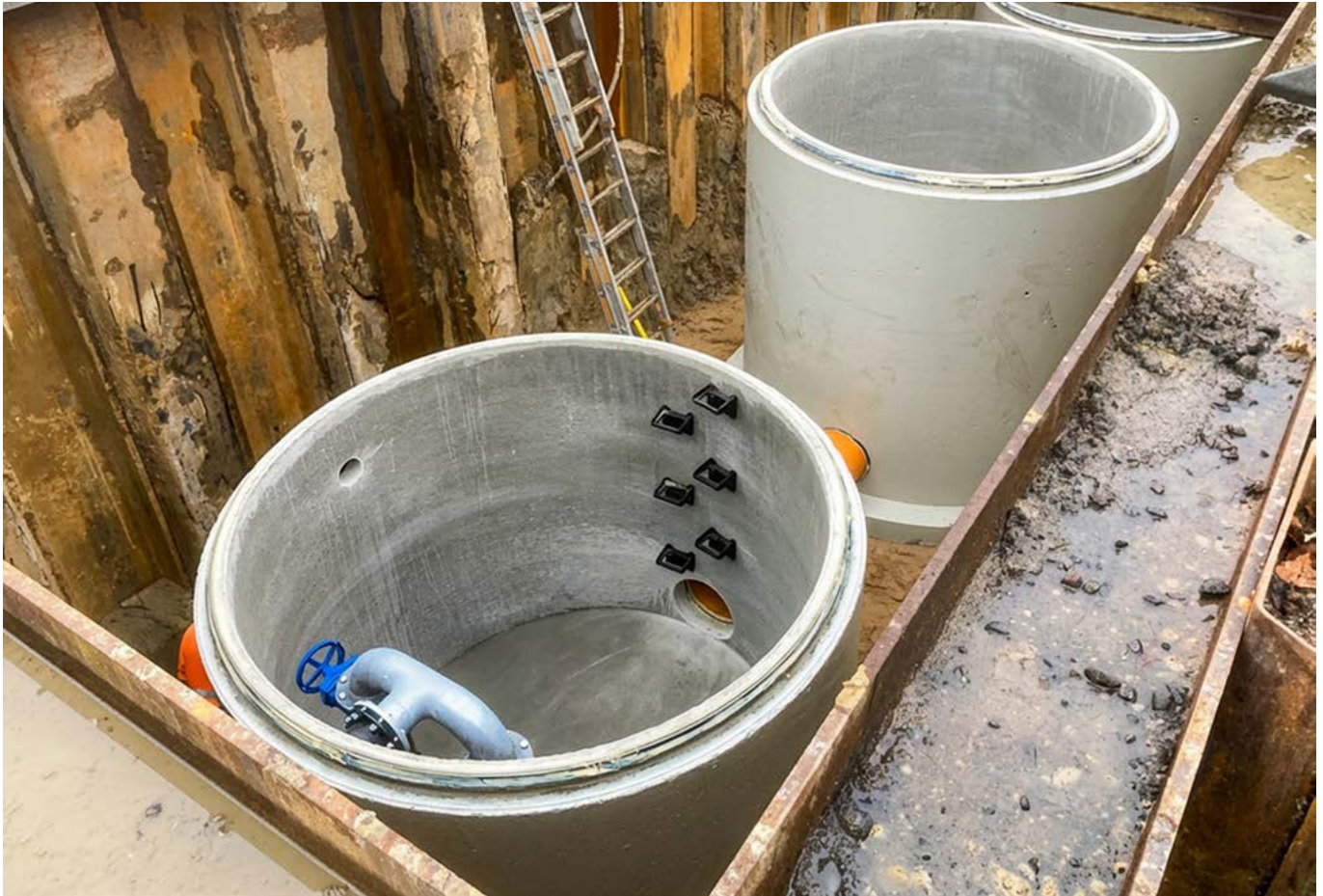
Regenwasser-Rückhaltung mit Doppelpumpstation
