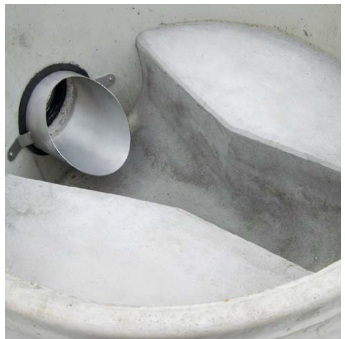
Ablaufrohr im Probenahmeschacht
