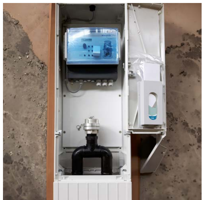
Freiluftschrank mit Steuerung (oben) und Rückstauschleife (unten)
