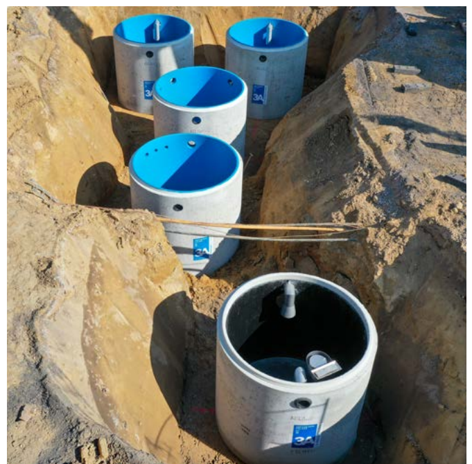
Beckentechnik für Wasserrecycling
