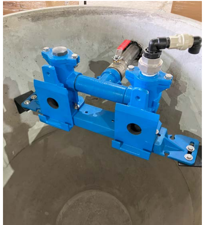
Einbaukomponenten im Pumpenschacht
