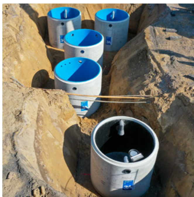
Beckentechnik für Wasserrecycling
