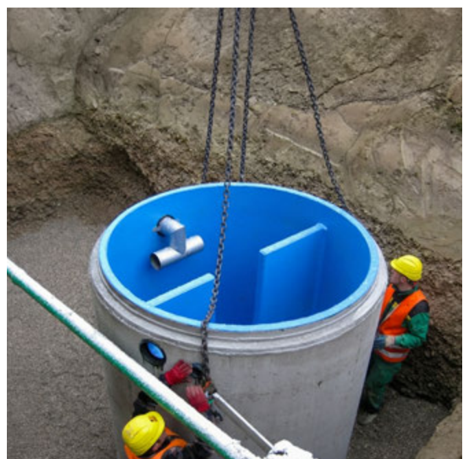
Funktionsbecken des Brauchwasser-Recyclings
