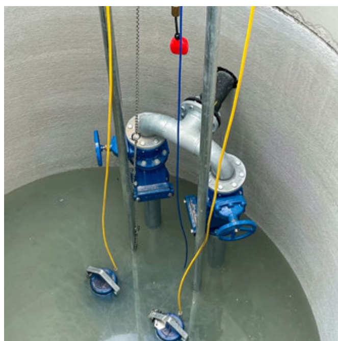
Pumpstation zur Regenwasserförderung
