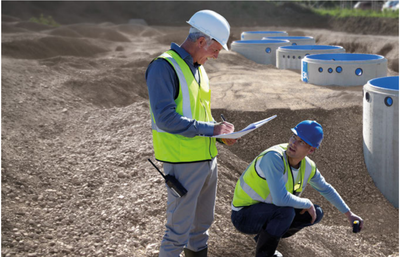
Maßarbeit auf der Baustelle: Exakt abgestimmte Behälterausführungen werden entsprechend den Höhenkoten versetzt
