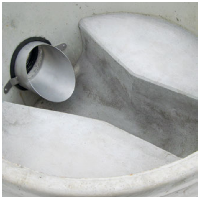
Ablaufrohr im Probennahmeschacht
