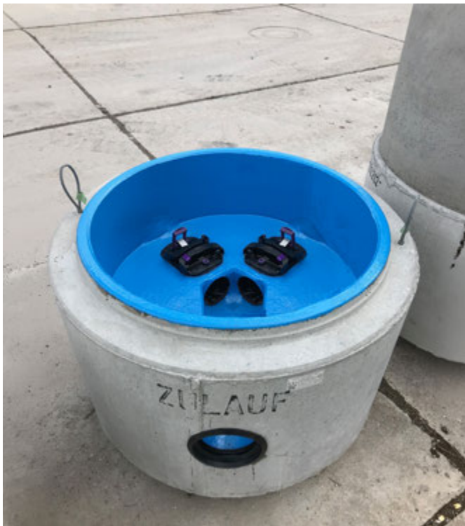
Umschaltenschacht zur Steuerung verschiedener Abwasserströme
