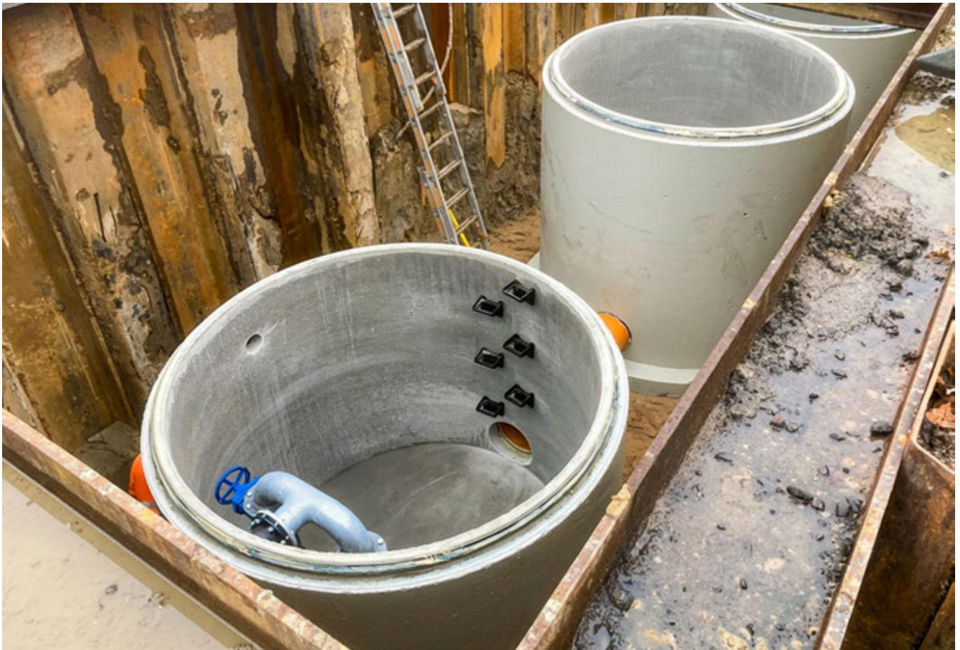
Regenwasser-Rückhaltung mit Doppelpumpstation
