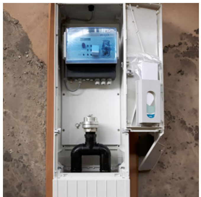
Freiluftschrank mit Steuerung (oben) und Rückstauschleife (unten)
