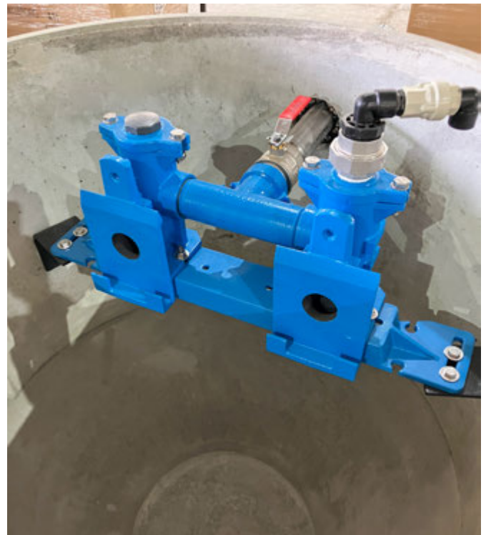
Einbaukomponenten im Pumpenschacht
