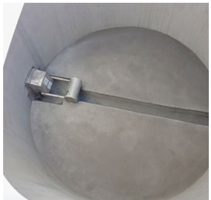
Drosselschacht mit Schwimmdrossel: kontrollierter Abfluss bei Einleitbegrenzung und Regenwasserrückhaltung
